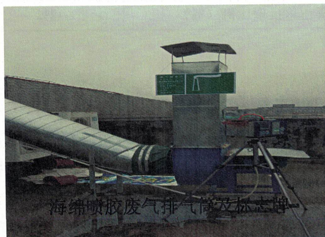
图 4.3.1.2 废气排气筒及标志牌
